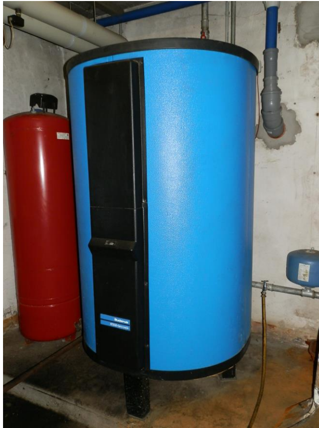
Foto: zentrale Trinkwassererwärmung
