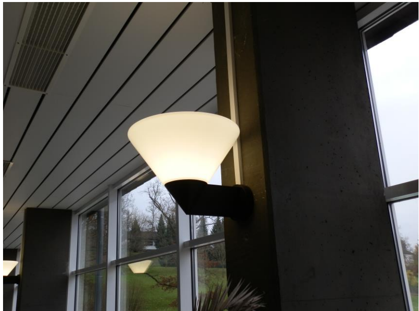
Foto: Schwimmhalle/Wandleuchte mit Kompaktleuchtstofflampe
