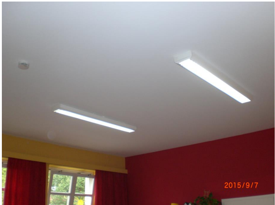
Foto: sanierte Beleuchtungsanlage, Langfeldleuchten mit EVG
