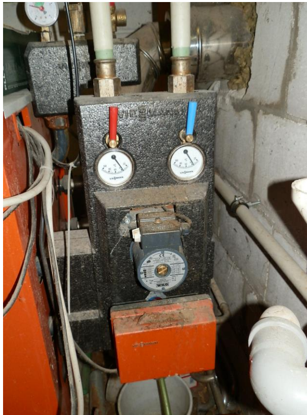
Foto: Heizungsumwälzpumpe und Dreiwege-Mischregelung
