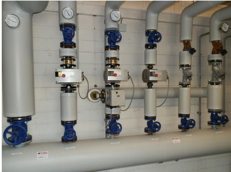
Foto: neue Pumpen und Verteiler
