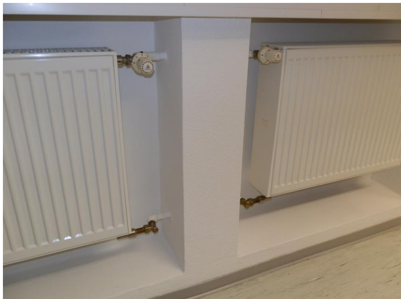
Foto: Heizkörper mit voreinstellbaren Thermostatventilen
