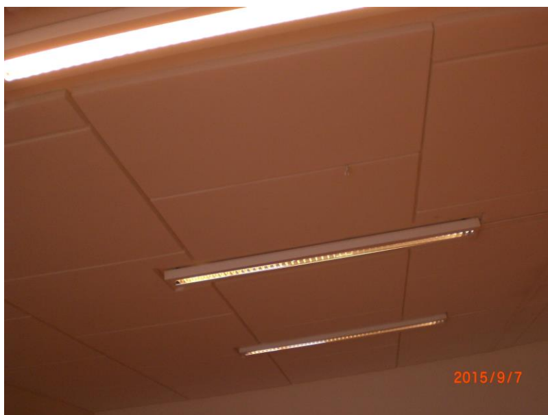
Foto: T5-Leuchtstofflampen mit elektronischen Vorschaltgeräten im Flur und im Turnraum
