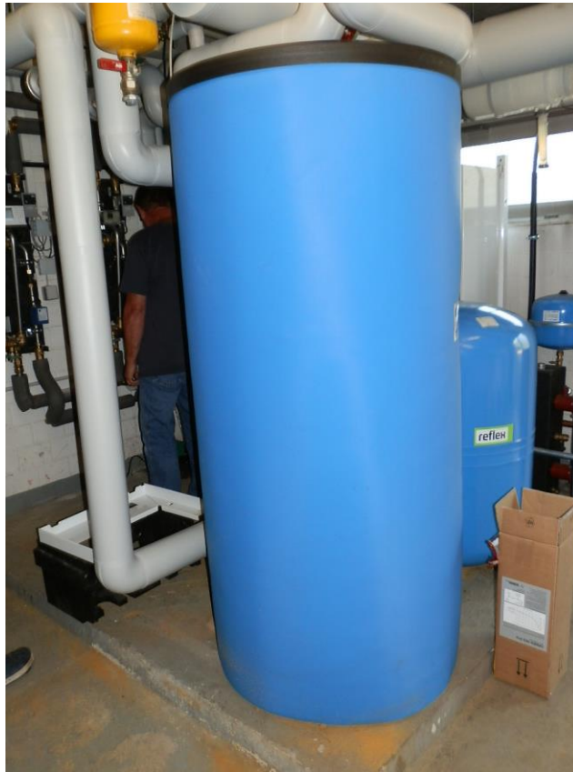
Foto: zentrale Trinkwassererwärmung
