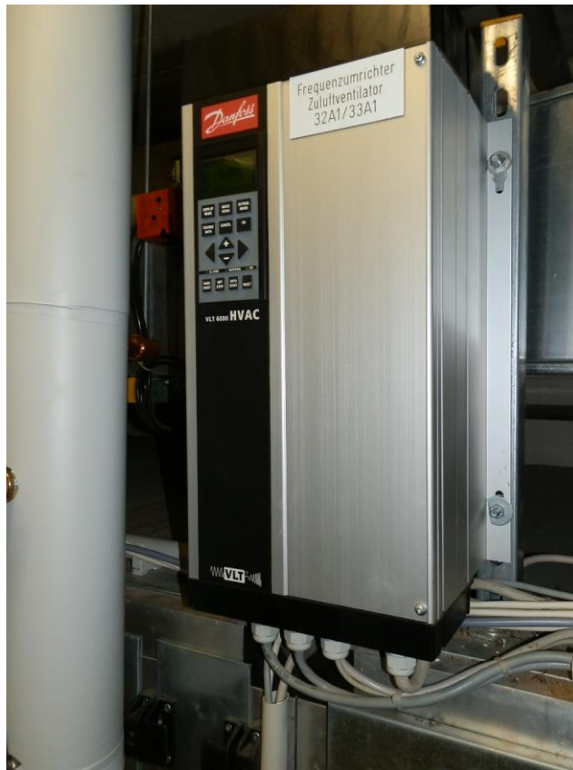
Foto: Frequenzumrichter Zuluftventilator
