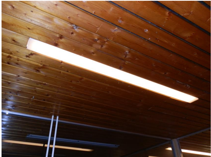
Foto: UG/Saunabereich – alte Einbauleuchten
