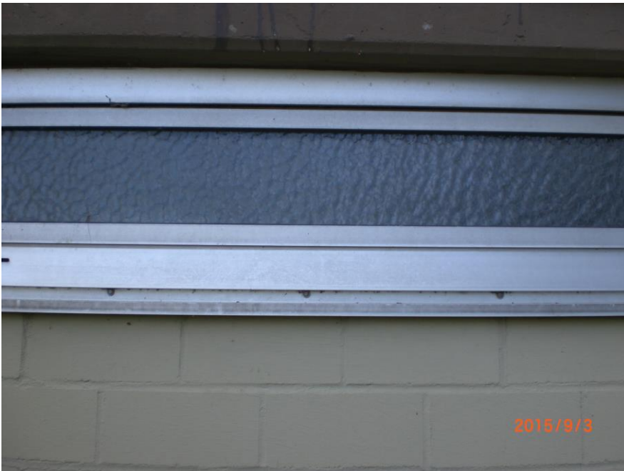
Foto: alte Isolierverglasung
