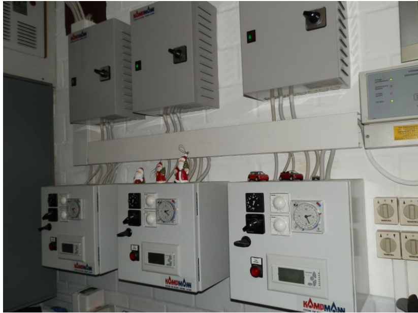
Foto: neue Steuergeräte für die Gebläse Halle
