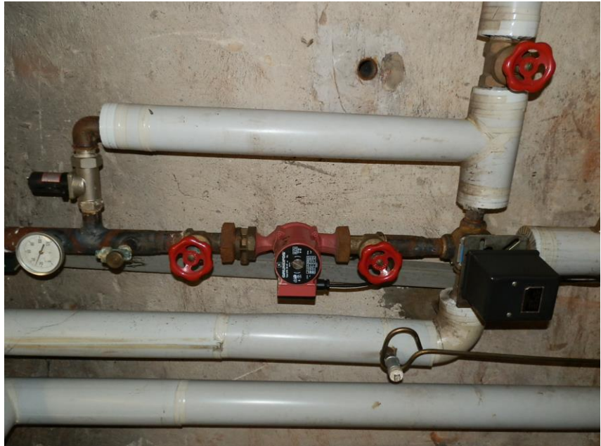
Foto: alte Vierwege-Mischregelung, Leitungen und Absperrventile ohne Dämmung
