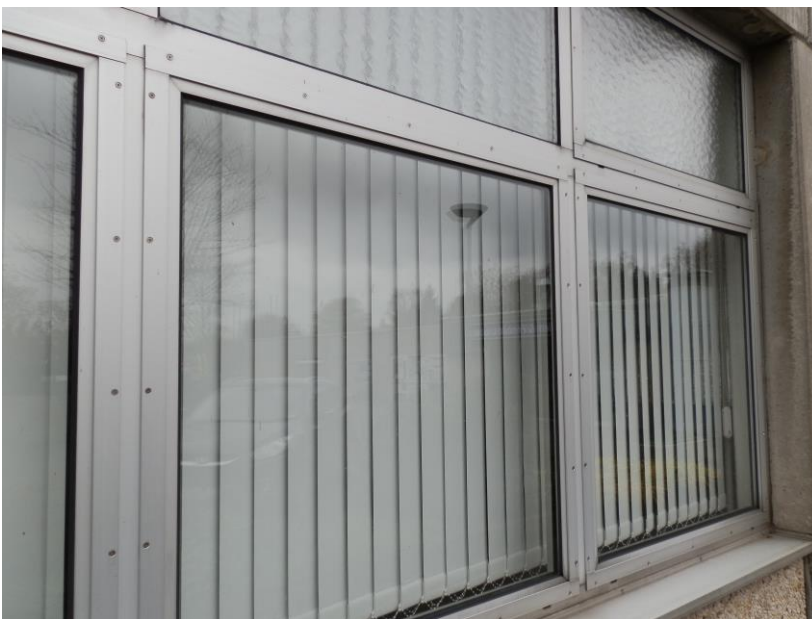
Foto: alte Isolierverglasung
