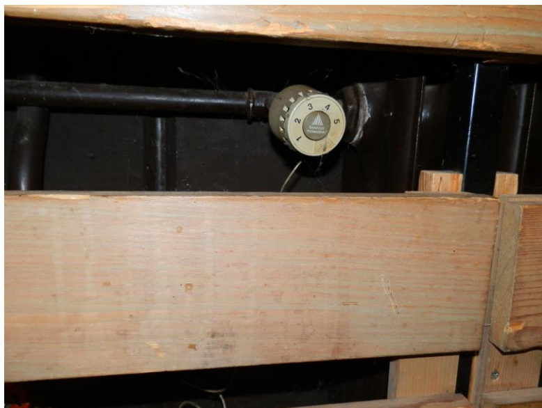
Foto: veraltetes Thermostatventil
