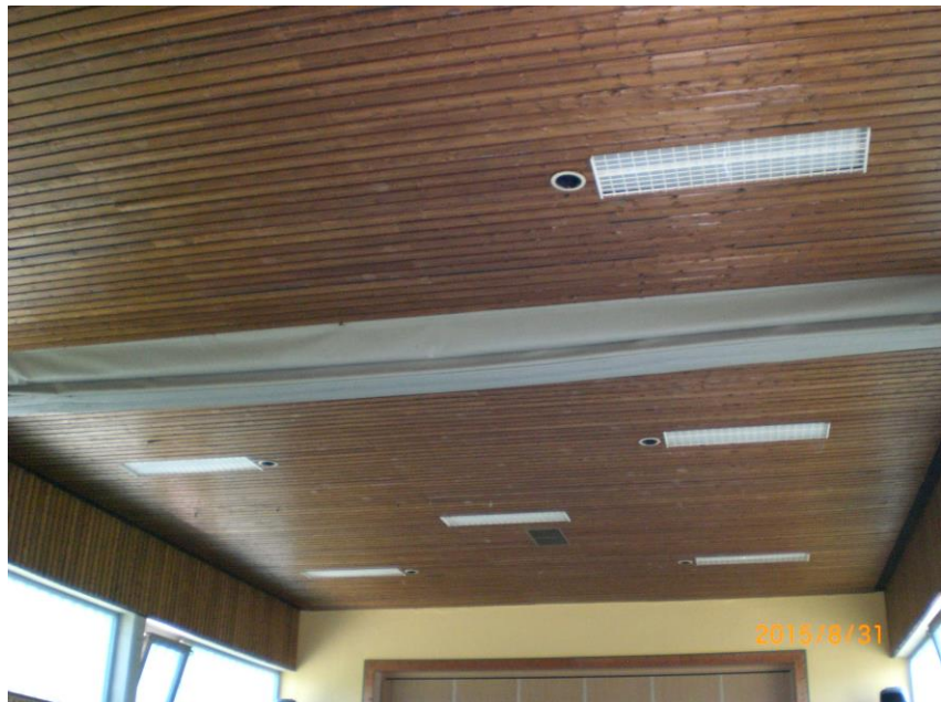
Foto: veraltete Beleuchtung/Saal
