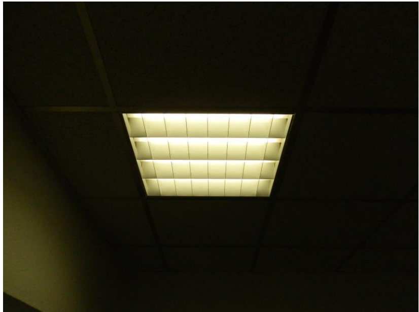
Foto: Klinkerbau, Raster-Einbauleuchte mit KVG
