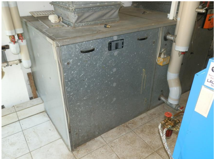
Foto: RLT-Anlage Saal
