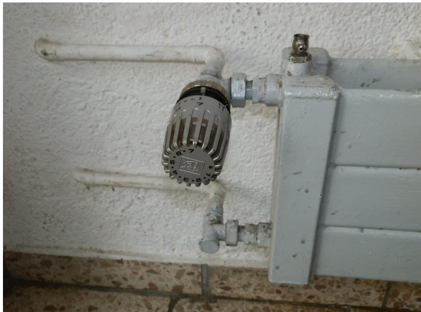
Foto: Heizkörper mit altem Thermostatventil
