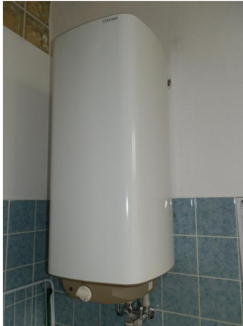
Foto: Klinkerbau, Elektroboiler Pflegedienst
