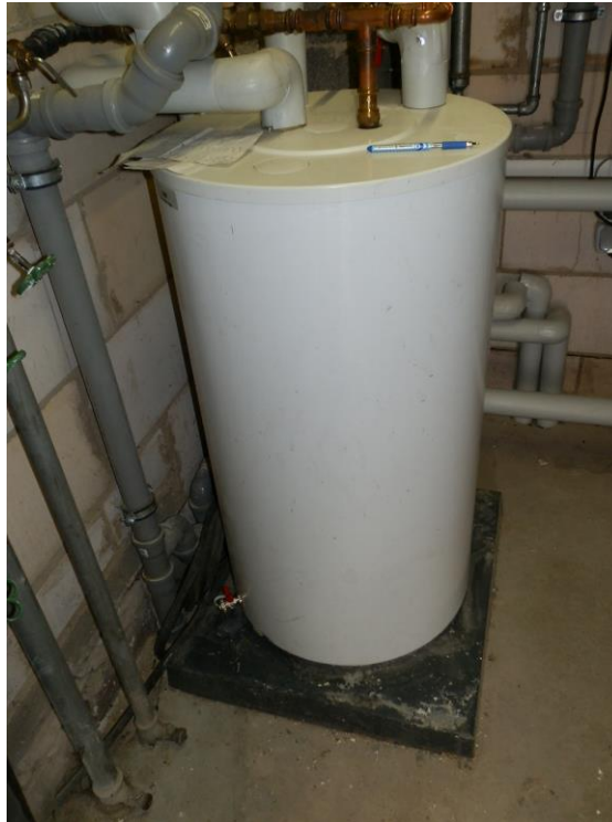
Foto: zentrale Trinkwassererwärmung
