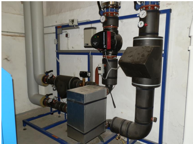
Foto: Fernwärme-Übergabe mit Wärmetauscher
