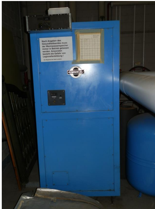
Foto: zentrale Trinkwassererwärmung
