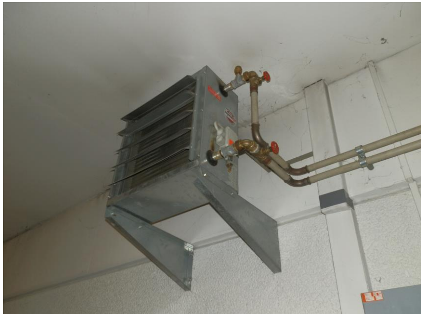
Foto: Warmluftgebläse Stuhllager
