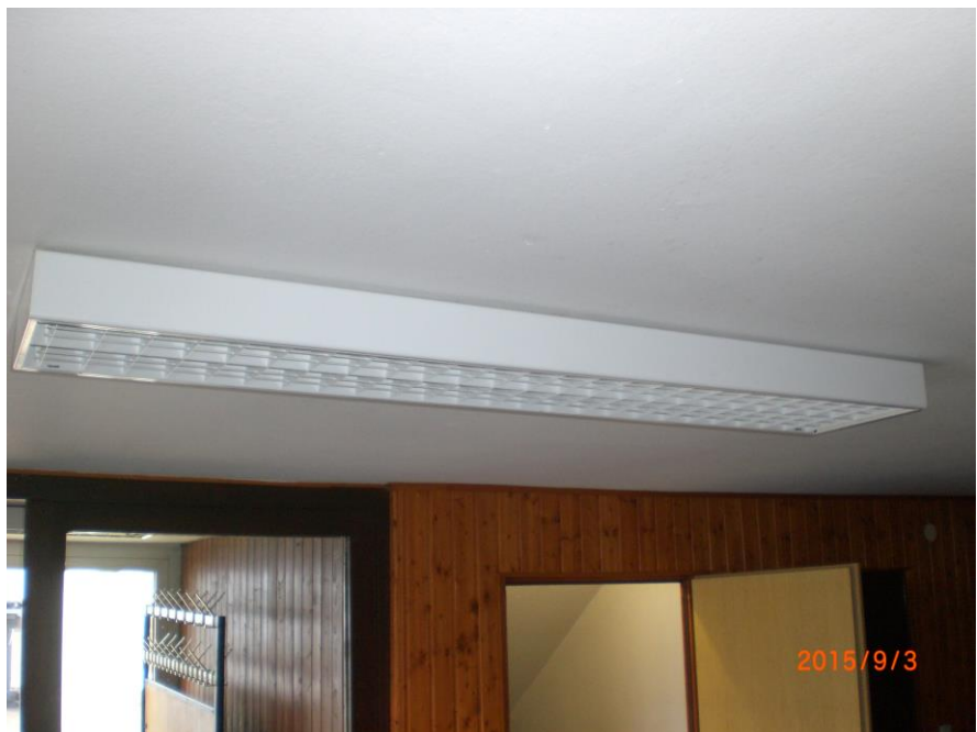
Foto: Beleuchtungsanlage Bereiche Theke/Eingang/Nebenraum
