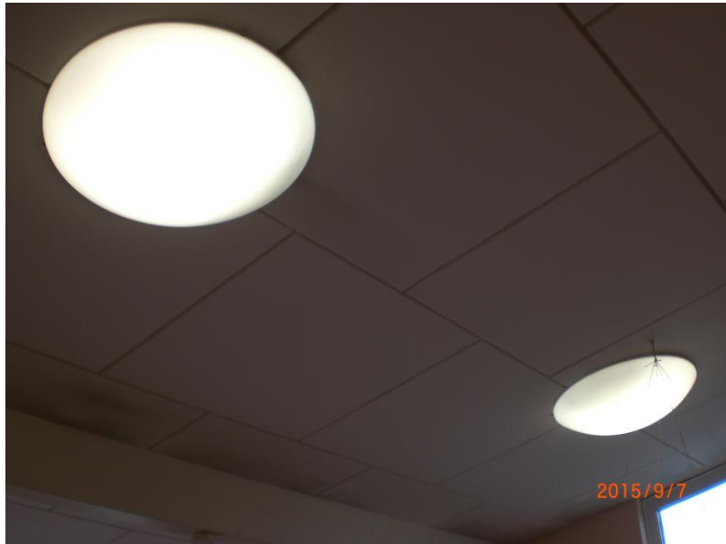
Foto: LED-Beleuchtung in den Gruppenräumen, dimmbar
