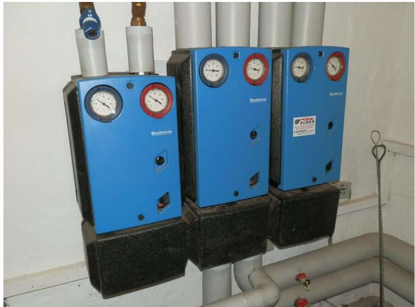
Foto: Umwälzpumpen mit Kleinverteilern
