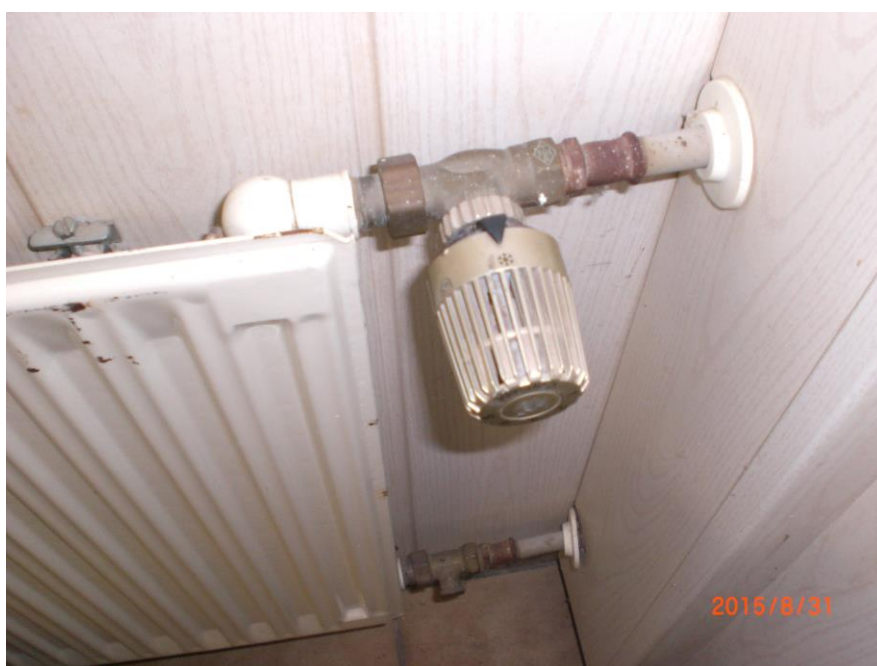
Foto: Heizkörper mit altem Thermostatventil
