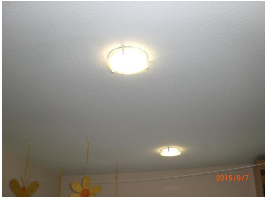
Foto: Energiesparlampen in den Fluren
