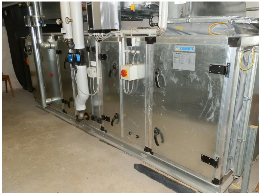
Foto: RLT-Anlage Saal
