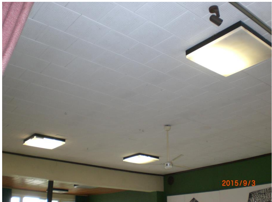
Foto: veraltete Beleuchtung im Saal
