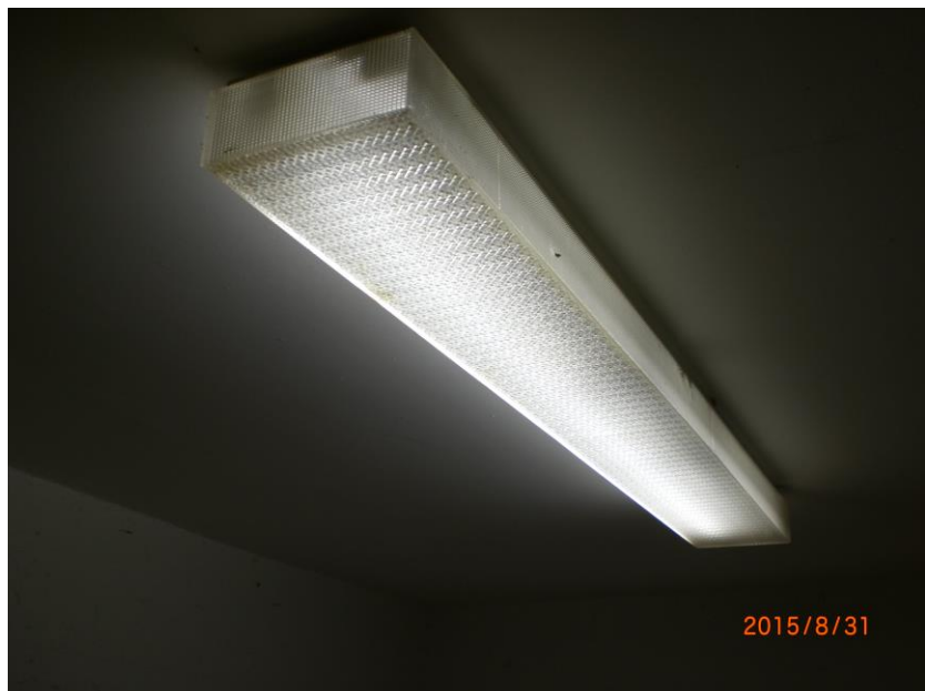
Foto: veraltete Beleuchtung/Umkleide
