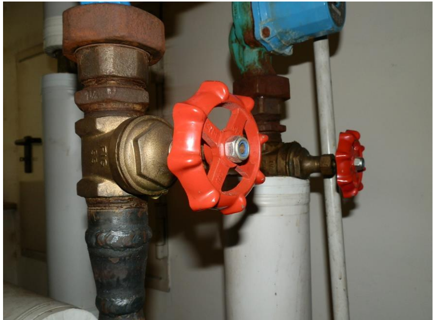
Foto: alte Absperrventile ohne Dämmung
