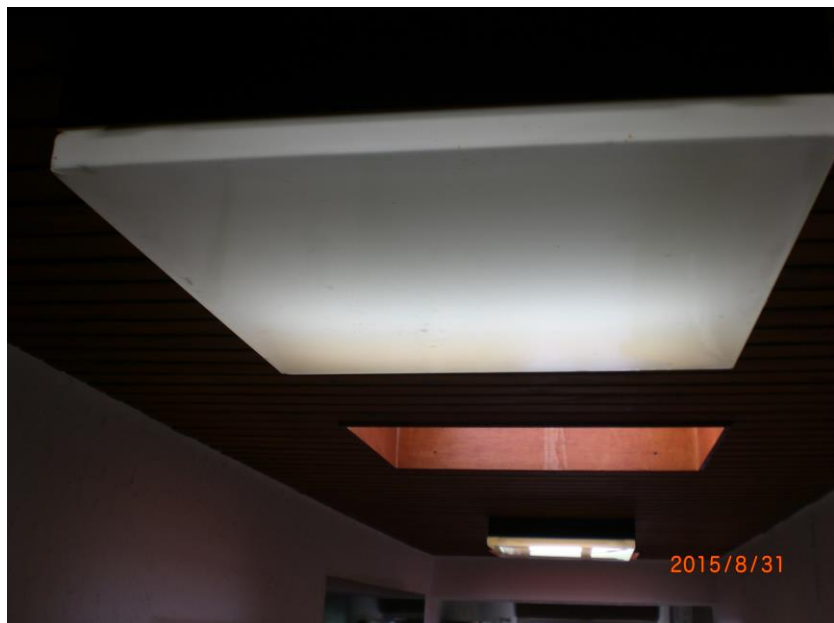
Foto: veraltete Beleuchtung/Eingang - Flur
