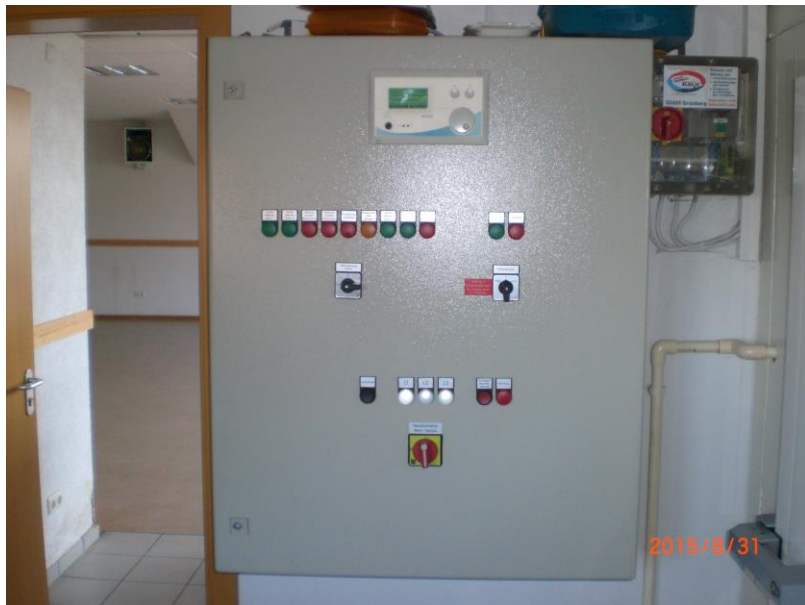
Foto: RLT-Anlage/Schaltschrank mit Regelung
