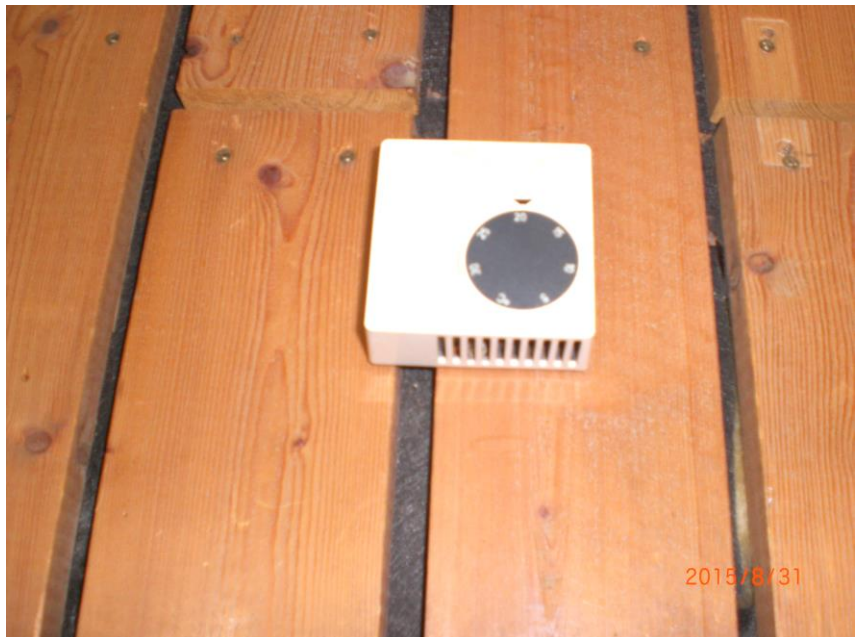
Foto: Thermostat zur Gebläsesteuerung
