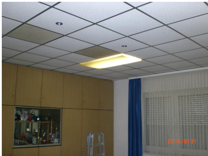
Foto: Beleuchtung Mannschaftsraum Feuerwehr
