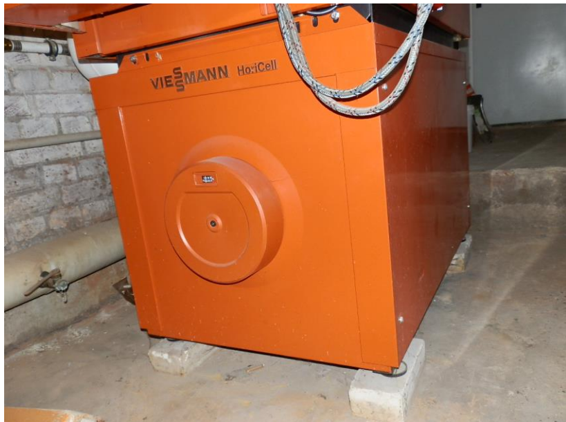
Foto: zentrale Trinkwassererwärmung
