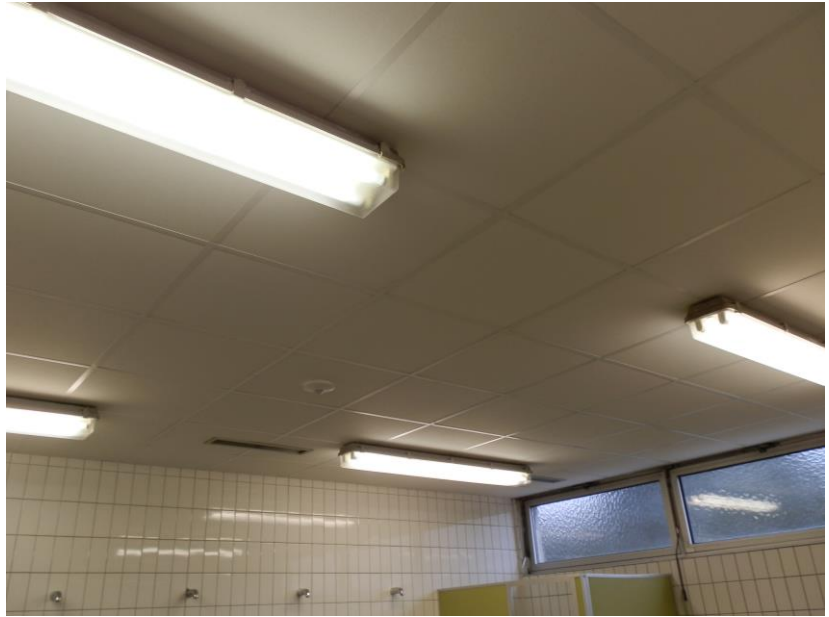
Foto: Duschraum, Beleuchtung mit Präsenzmeldern
