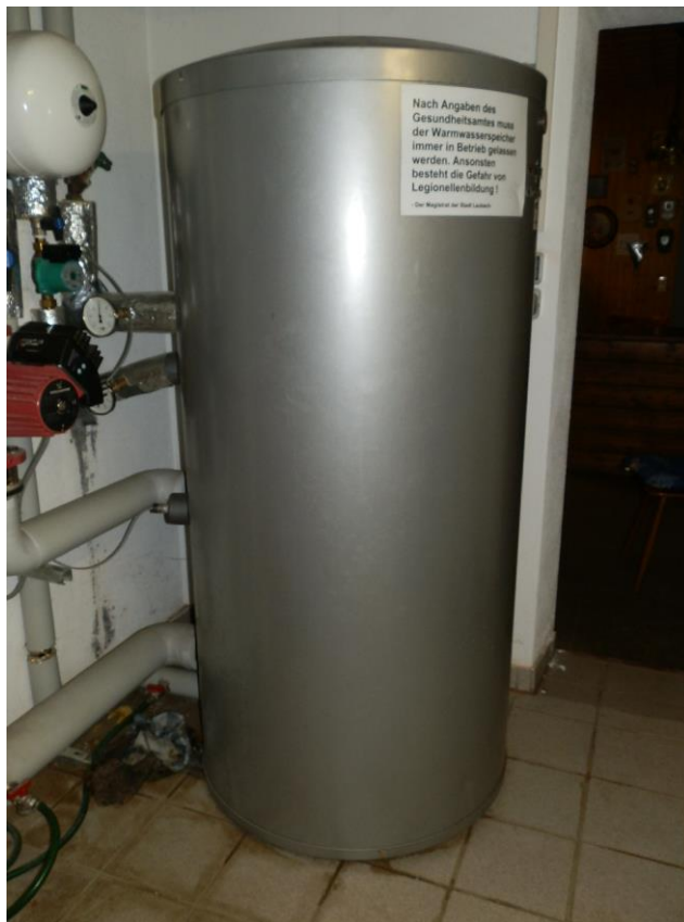
Foto: zentrale Trinkwassererwärmung
