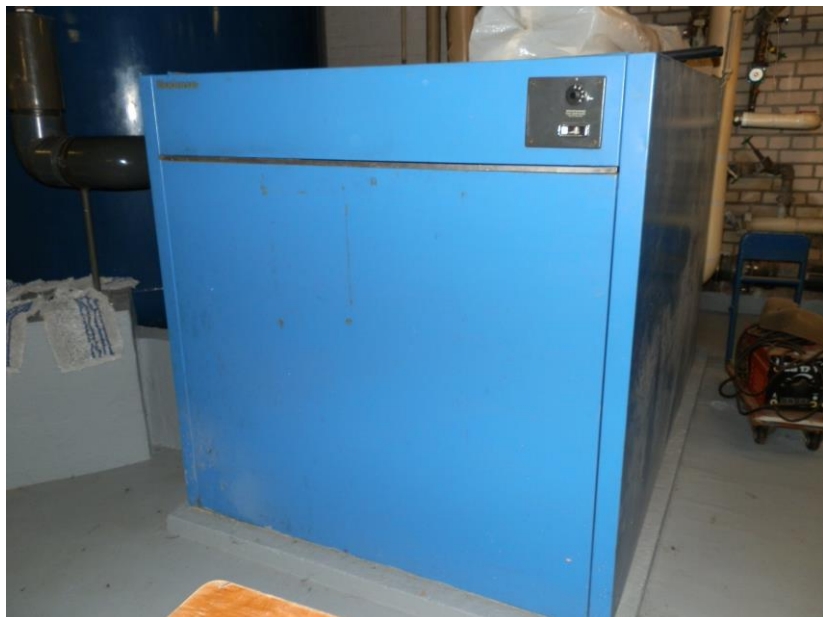
Foto: zentrale Trinkwasserwärmung
