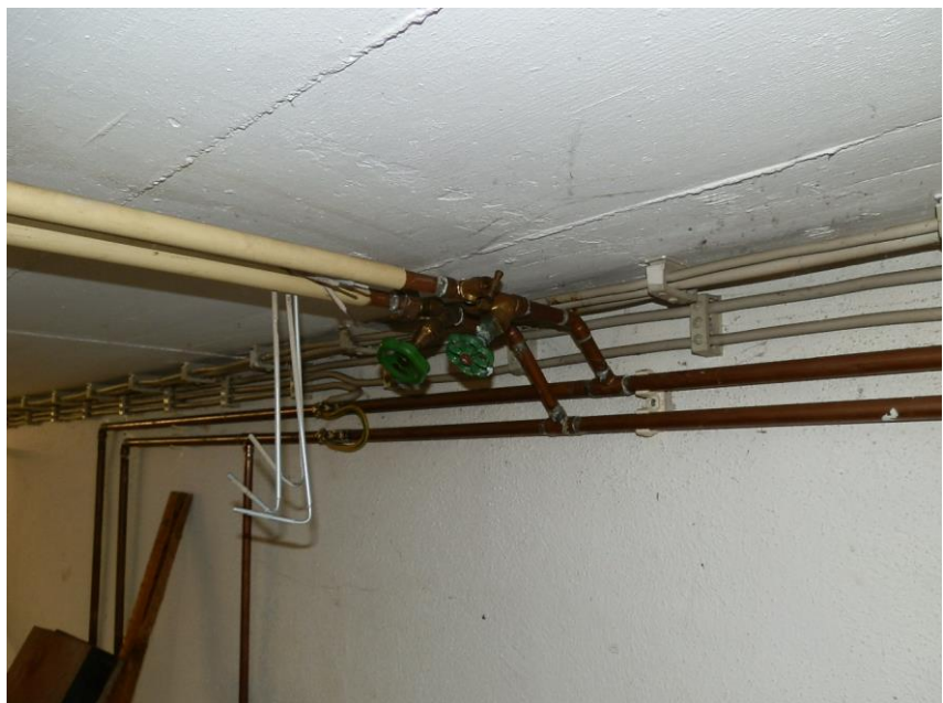
Foto: ungedämmte Heizungsleitungen
