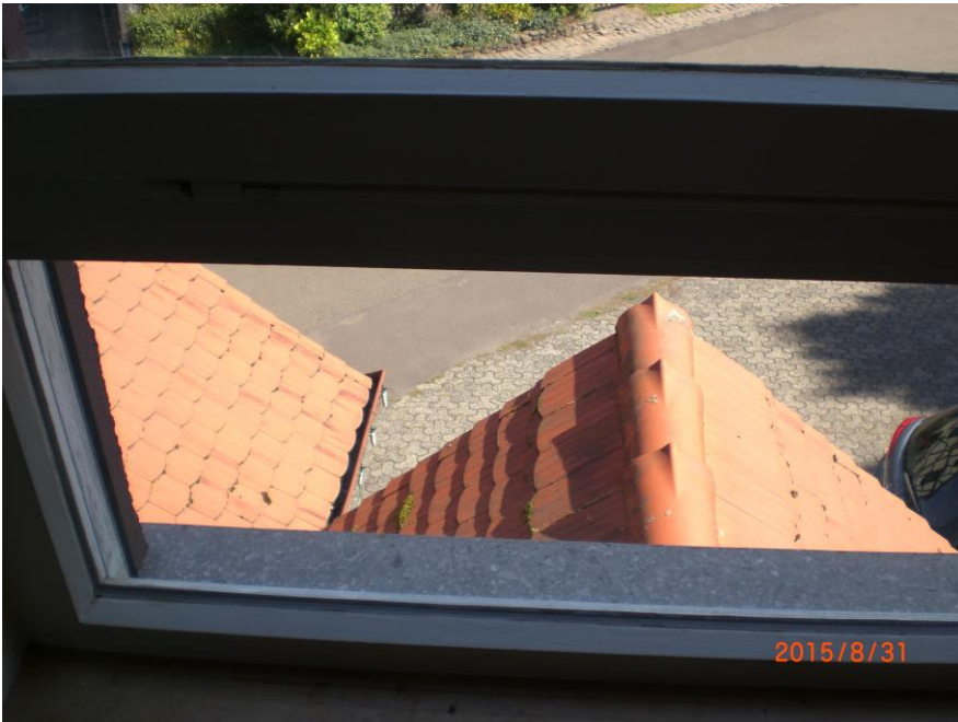
Foto: alte Isolierverglasung
