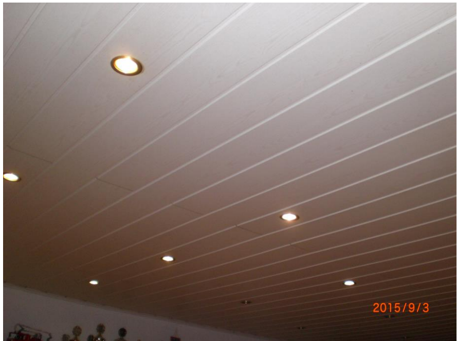
Foto: Halogenbeleuchtung im Veranstaltungsraum
