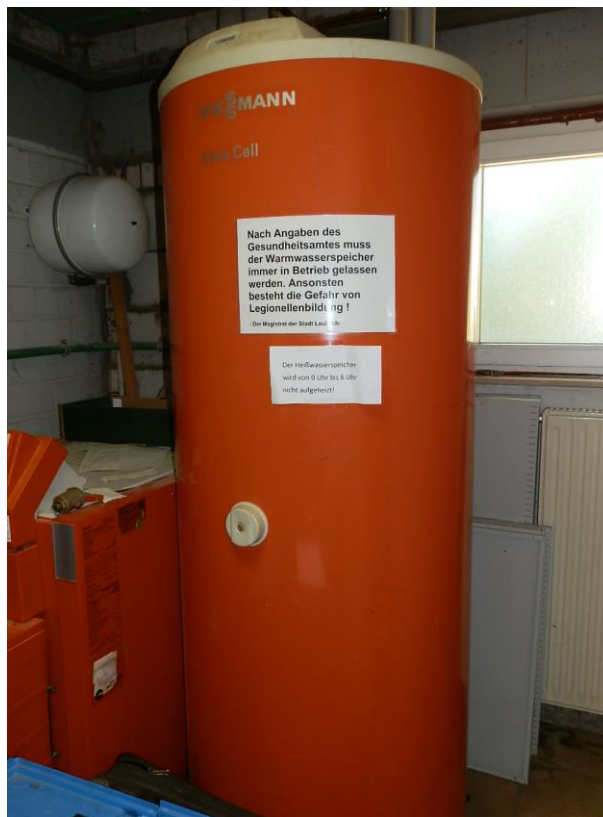
Foto: zentrale Trinkwassererwärmung
