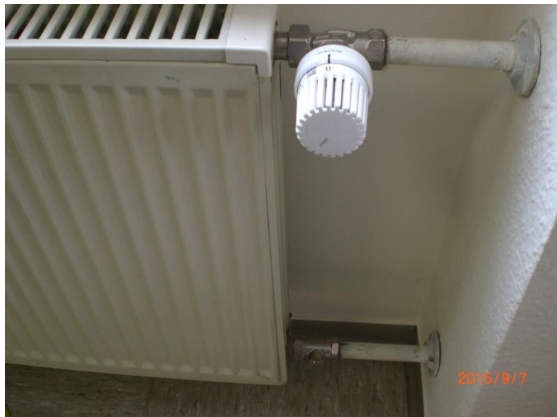
Foto: Heizkörper mit Thermostatventil und Rücklaufverschraubung
