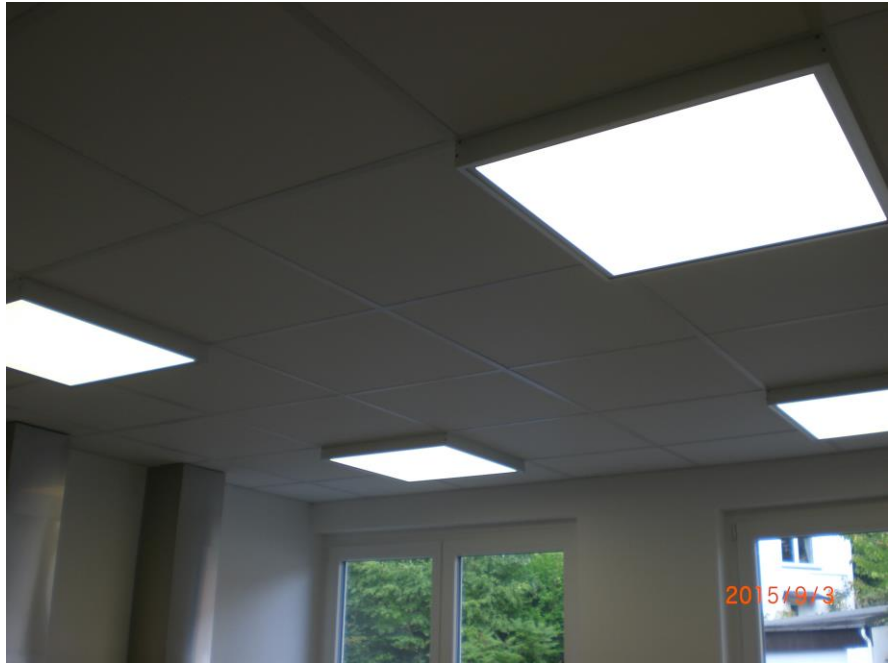
Foto: erneuerte Beleuchtung in der Küche
