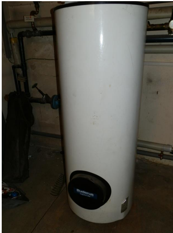
Foto: zentrale Trinkwassererwärmung
