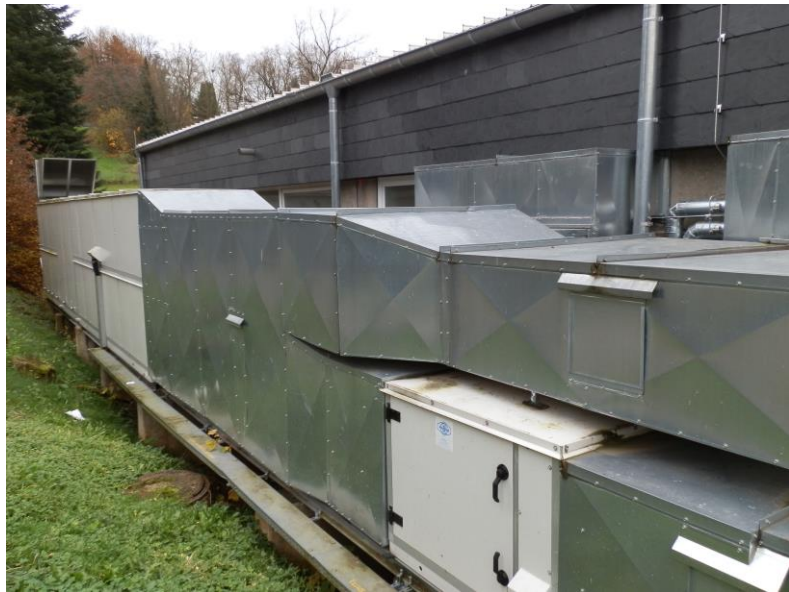
Foto: RLT-Anlage Schwimmhalle
