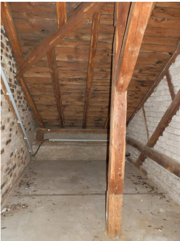
Foto: Klinkerbau/Anbau, Dach ohne Dämmung
