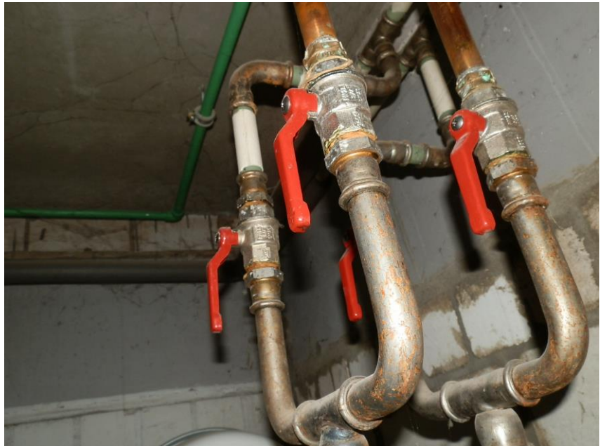
Foto: ungedämmte Leitungen und Absperrventile
