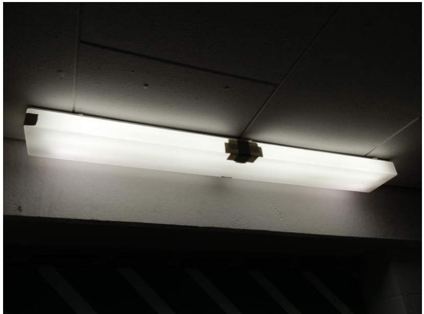
Foto: Lehrer-Umkleideraum, veraltete Leuchte
