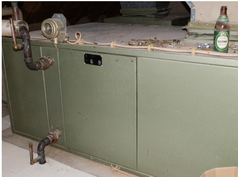
Foto: RLT-Anlage Saal
