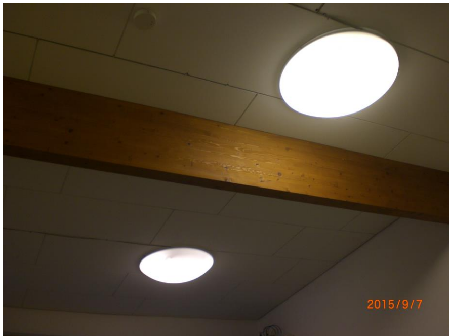
Foto: Beleuchtungsanlage in den Gruppenräumen
