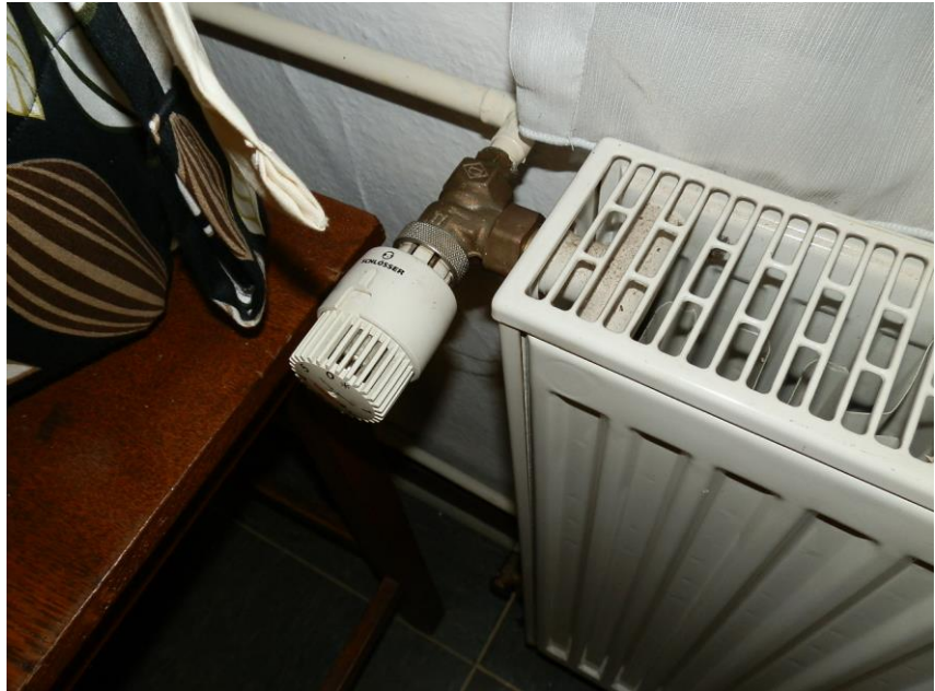
Foto: Heizkörper mit Thermostatventil und Rücklaufverschraubung
