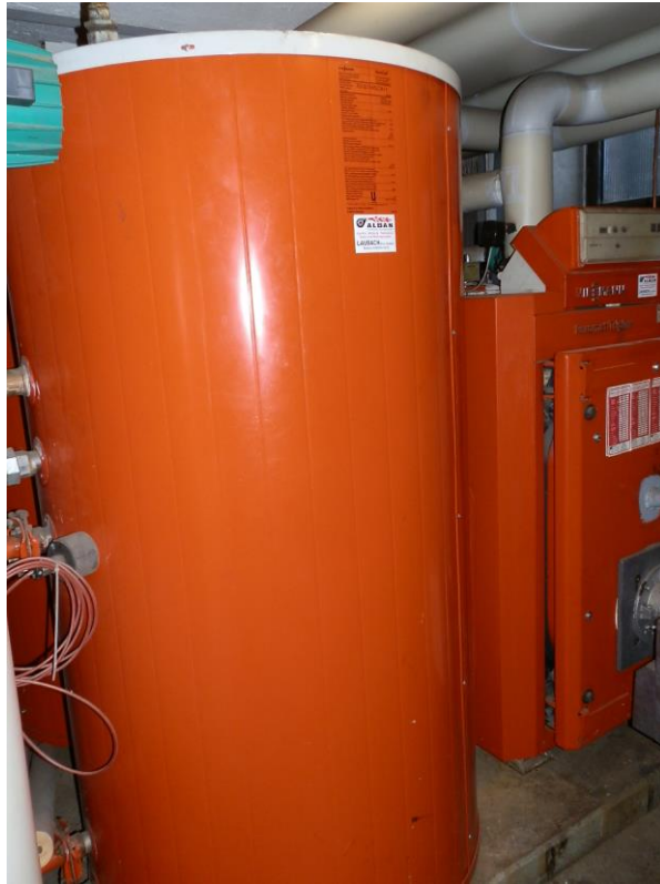
Foto: zentrale Trinkwassererwärmung
