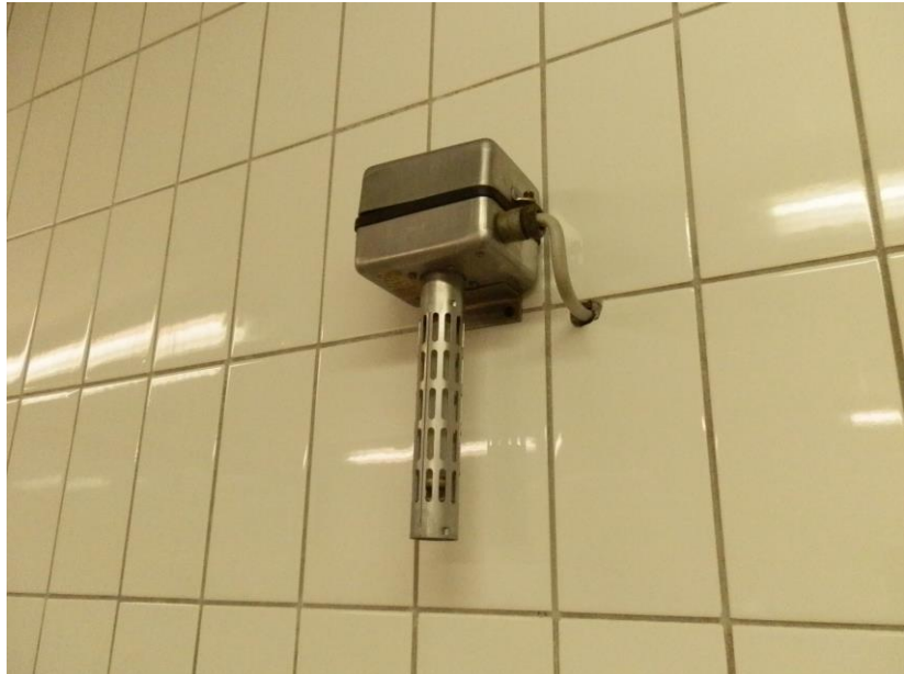
Foto: Feuchtefühler Duschraum
