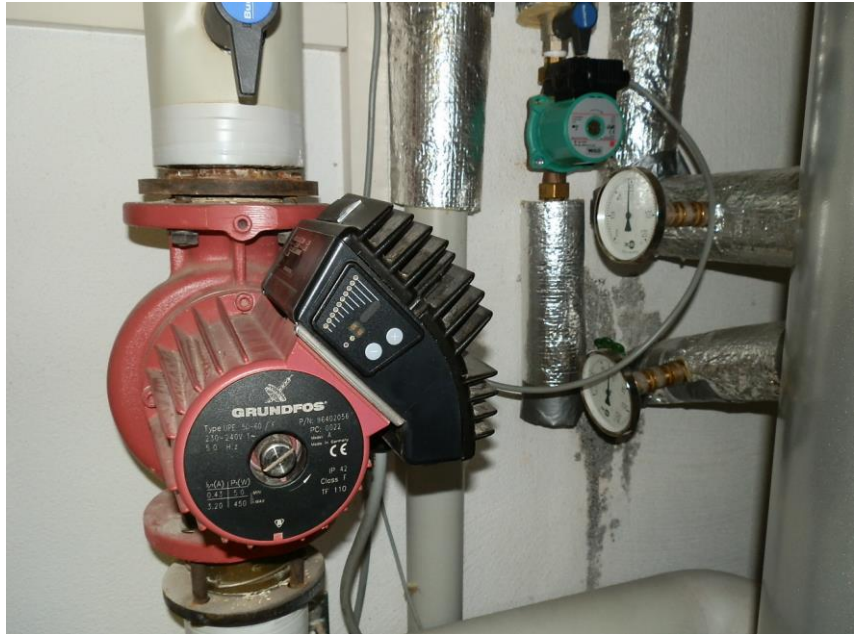
Foto: Speicherlade- und Zirkulationspumpe
