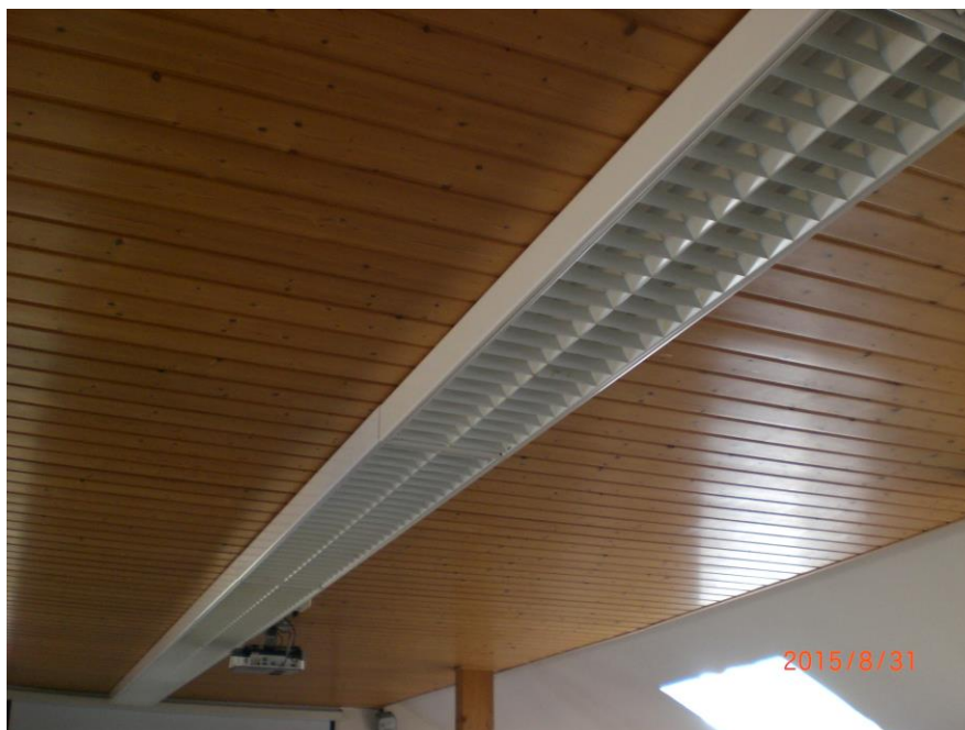
Foto: Beleuchtungsanlage Veranstaltungsraum
