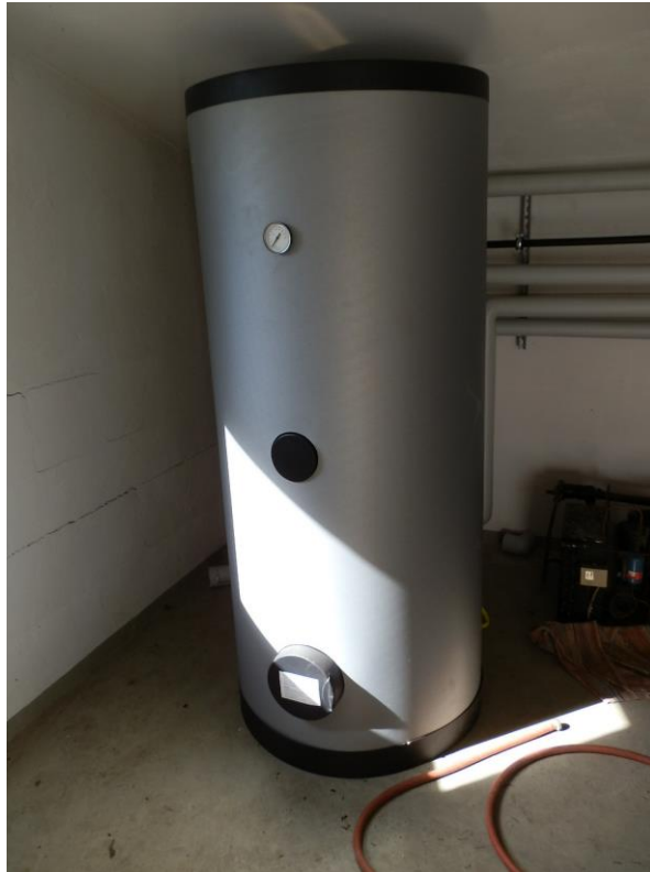
Foto: zentrale Trinkwassererwärmung
