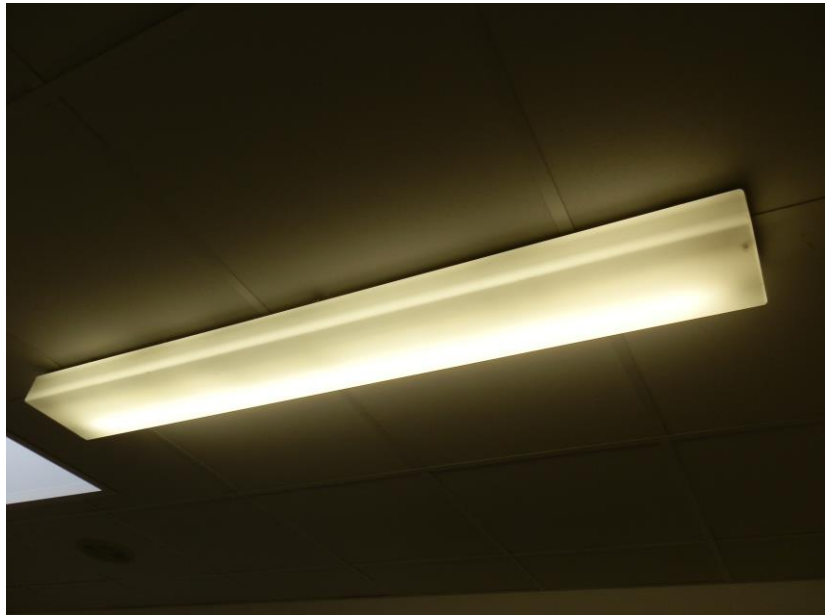
Foto: Umkleideraum, alte Opalwannenleuchte
