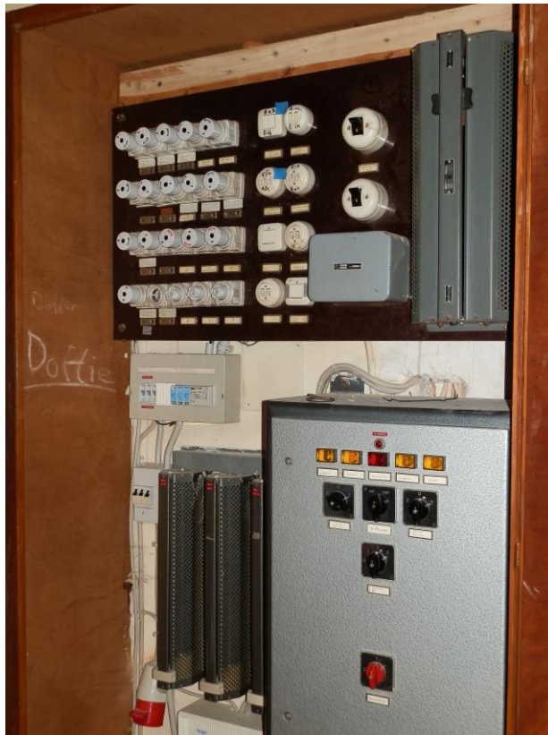
Foto: veraltete Schalttechnik
