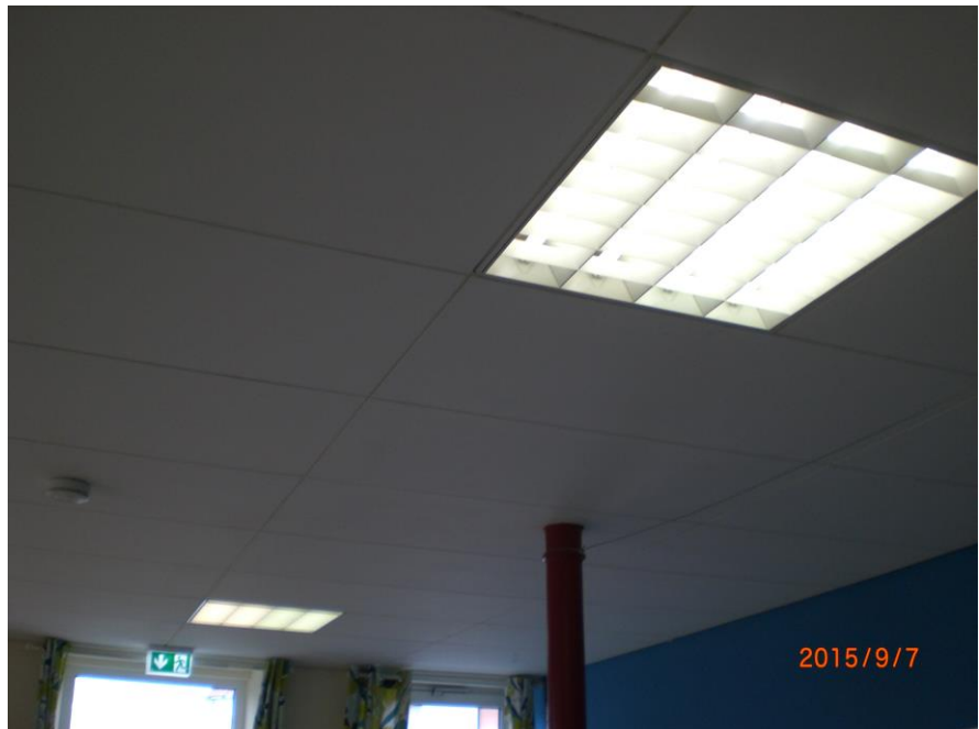
Foto: veraltete Beleuchtungsanlage, Rasterstegleuchten
