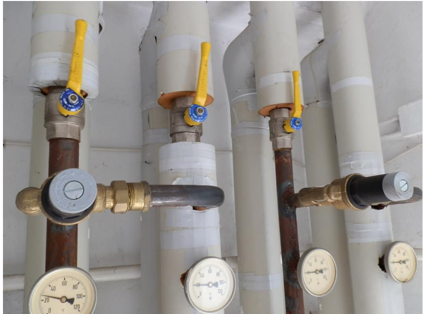
Foto: Heizleitungen und Absperrventile ohne Dämmung
