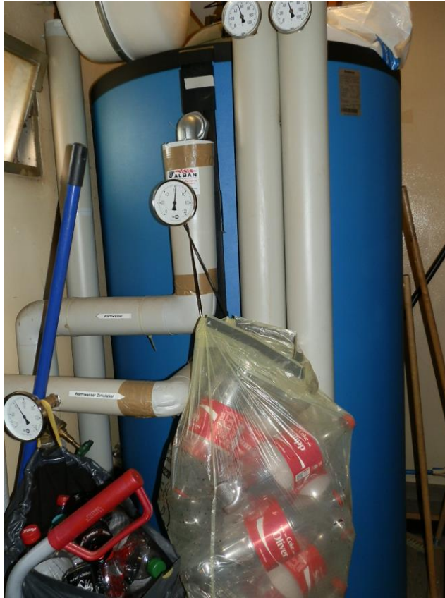
Foto: zentrale Trinkwassererwärmung
