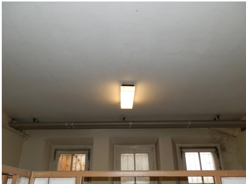
Foto: Toilette UG, stark veraltete Leuchte
