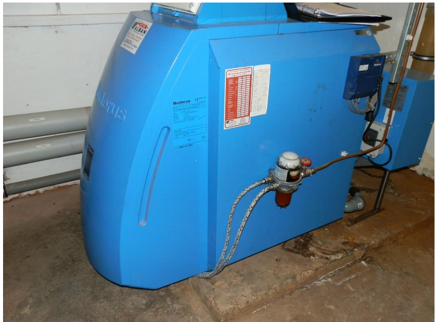
Foto: Kessel mit Brennwertnutzung
